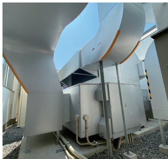
体育館 (熱回収フード付)
