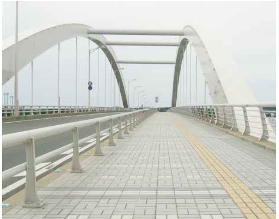
事故後、歩車道境界に車両用防護柵(モデストタイプ)が新たに設置された海の中道大橋 2本レール H850
