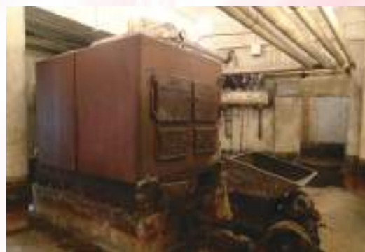
滋賀の豊郷小学校の地下室に残るアサヒボイラーS型。戦時供出等で現存する個体は極めて少ない。自動給炭器が付いている。(撮影協力:豊郷町教育委員会)
